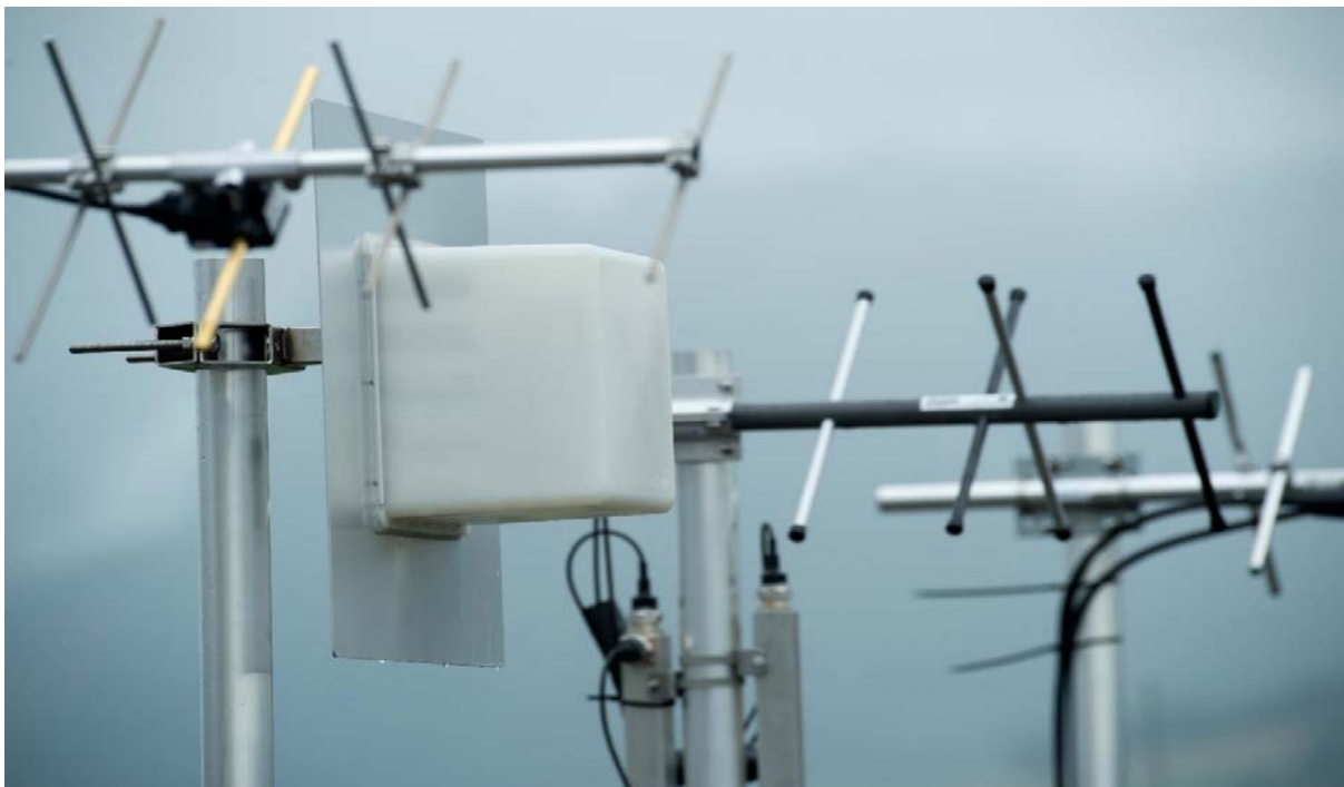
Abbildung 16: Messaufbau zur Beurteilung der zeitlichen Degradationen von Kommunikationsantennen.
